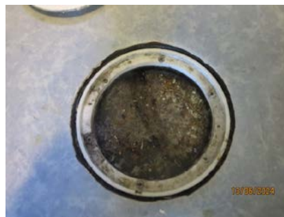
Sluk på bod, tekn. rom ikke rengjort, har ikke vært i bruk på lenge. Må rengjøres.
