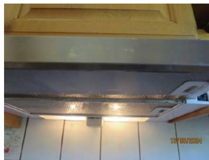
Bilde tatt mot kjøkken ventilator etablert over komfyr m/ komfyr vakt, avtrekk ut over tak.
