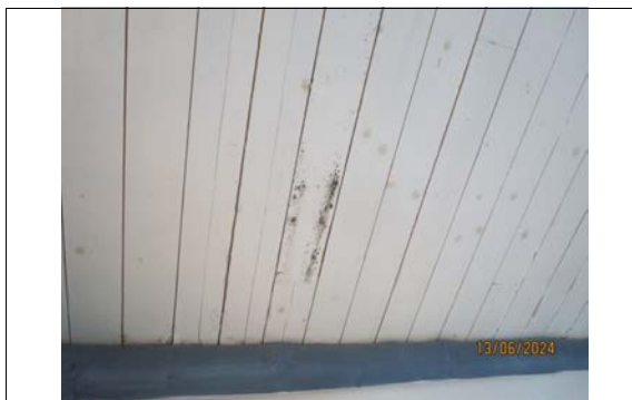
Bilde viser mugg dannelser i tak på grill huset, har manglende lufting. det er fukt, muggdannelser til deler av konstruksjonen også.
