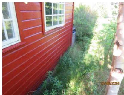
Bilde viser kledning gavli side mot vei, ført ned mot terrenget
