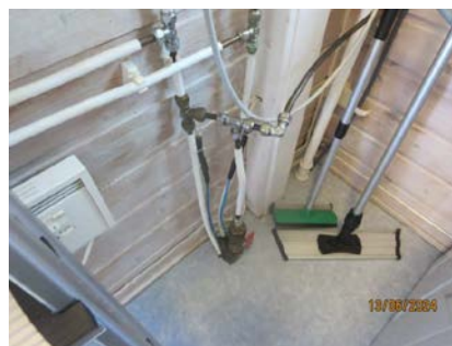
Bilde viser åpent anlegg til rør føring. Inntak vann kommer opp via gulvet m/ videre fordelinger gjennom vegg til badet.
