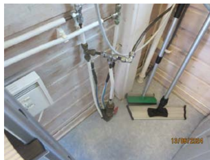
Bilde viser røropplegg til vann, hvor hoved inntak kommer opp gjennom gulvet. Etablert stoppekran på hoved inntak, varmekabel på inntak.
