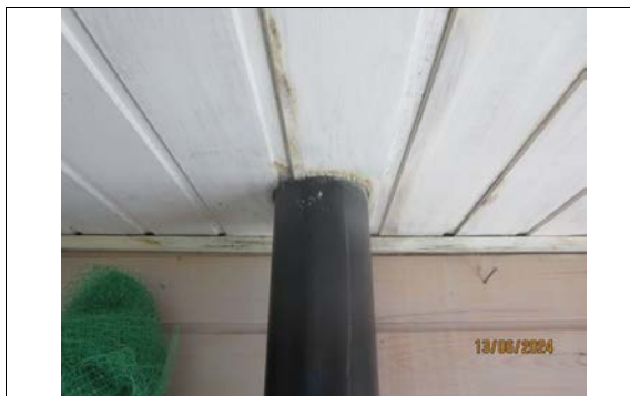
Fukt merker i tak på ute- do annekset.
