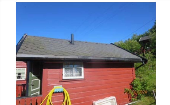
Bilde viser groing på tak til annekset. Ikke luftede deksel over soil rør fra ute-doet Utbedring av takrenne anbefales, slitt kledning, vedlikehold trengs
