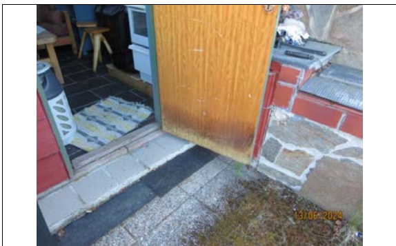
Slitt, skadet dør til grill huset, tar henger, vanskelig å lukke
