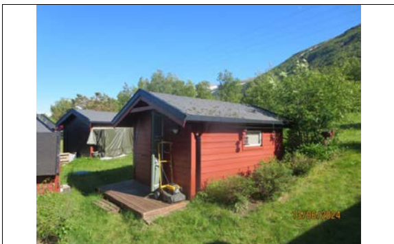
Bilde viser mosegroing på arbeidsrom, bod
