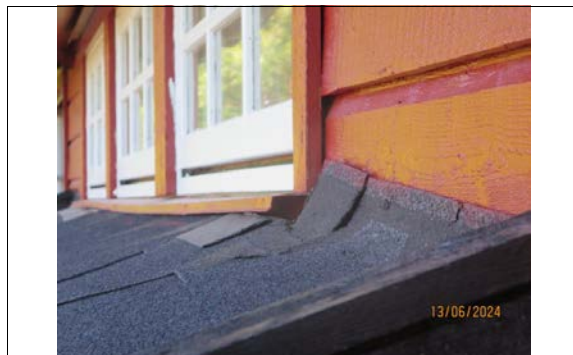
Bilde viser åpning i tak mot hoved hytta fra utvendige uisolerte bod. Må ordnes Mosegroing på taket
