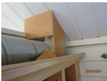
Bilde tatt mot avtrekk spiro kanal fra ventilator og ut. Dels åpen spiro. Ikke innkasset.
