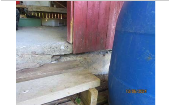
Skade, glippe, åpning til betongdekke naust.
