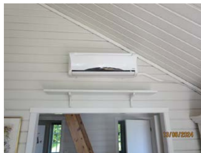
Bilde tatt mot utkast til varmepumpe etablert på vegg til åpent rom stue, kjøkken gangs sone
