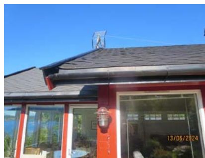
Bilde viser løse soner til papp shingelen ut mot vindski
