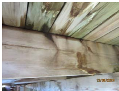
Bilde viser fukt på bjelker og bord i mindre sone, flis over som har sprukket, fuger løse. er på sone hvor det er lagt flis på terrasse
