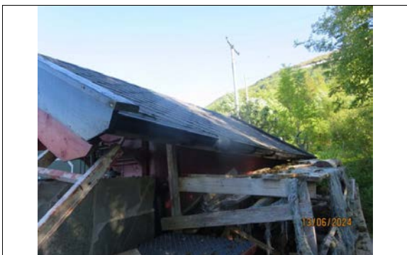
Takrenne på grill husets ene side har mangler, dels defekt. Materialer mot vegg hindrer lufting til konstruksjonen, fare for fukt, muggdannelser.
