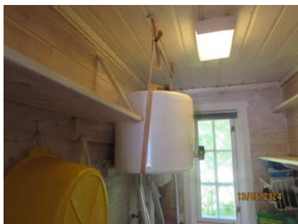
Bilde tatt mot VVB etablert på bod, tekn. rom
