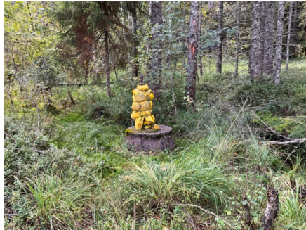
Vannpost i området.
