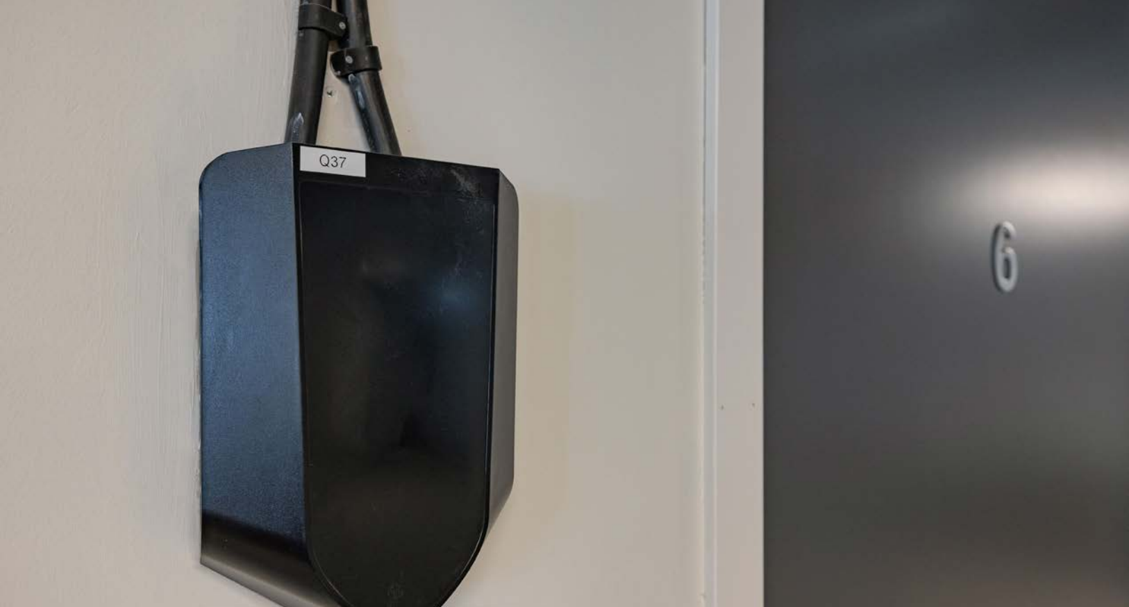
Det er montert elbil-lader.
