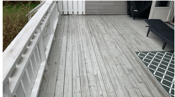
Det er etterslep på vedlikehold av overflater.
