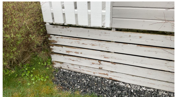
Det er etterslep på vedlikehold av overflater.
