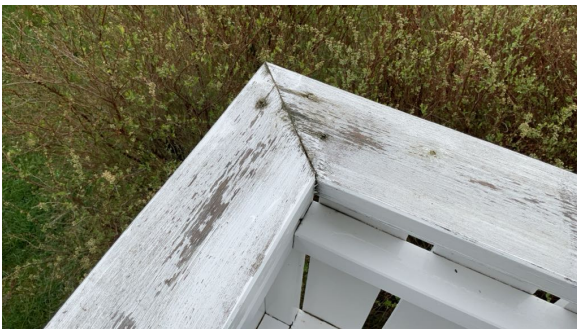
Det er etterslep på vedlikehold av overflater.
