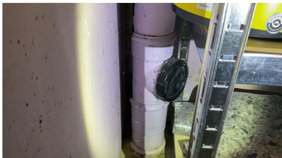
Stakeluke i bod i kjeller
