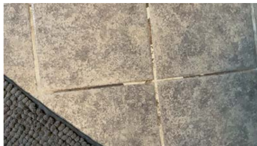
Misfarging av fuger.
