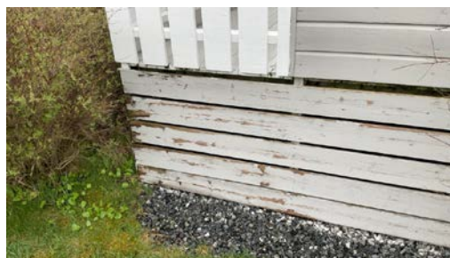
Det er etterslep på vedlikehold av overflater.
