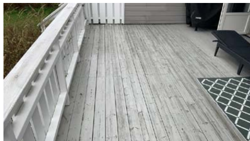
Det er etterslep på vedlikehold av overflater.
