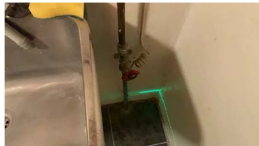
Stoppekran i vaskerom i kjeller
