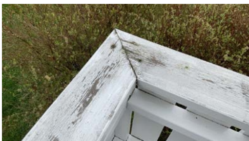
Det er etterslep på vedlikehold av overflater.
