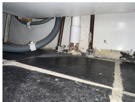
Eldre kobberør på bad.
