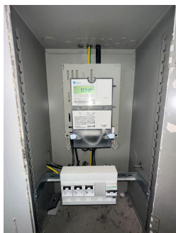
Sikringsskap med automatsikringer.
