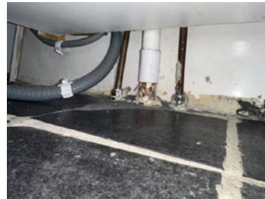
Eldre kobberør på bad.
