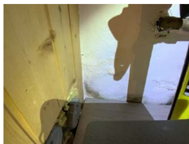
Saltutslag på enkelte steder på grunnmur.
