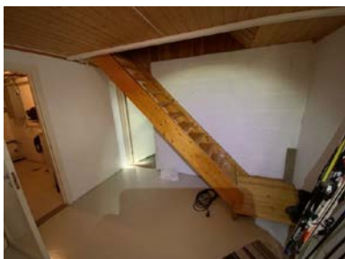
Det er ikke montert rekkverk.
