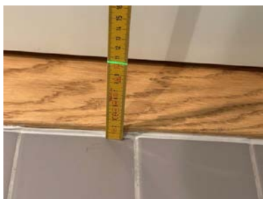
Fallforhold ca. 104 mm overkant gulv ved terskel
