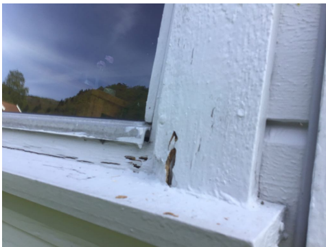
Fukt/råteskader i nedkant vindu
