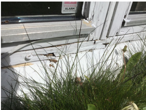
Råteskader i underkant vinduer
