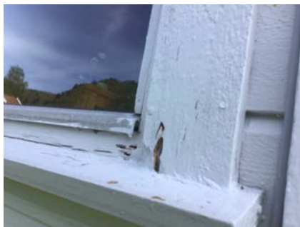
Fukt/råteskader i nedkant vindu
