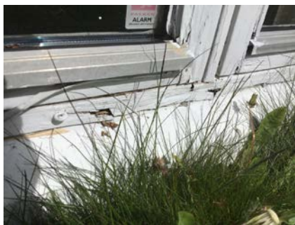
Råteskader i underkant vinduer
