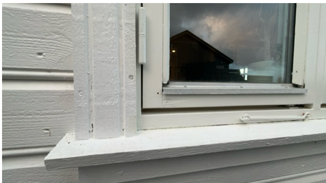
Litt råte i rammen.
