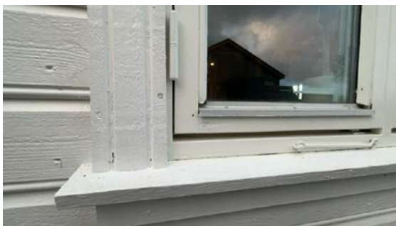
Litt råte i rammen.
