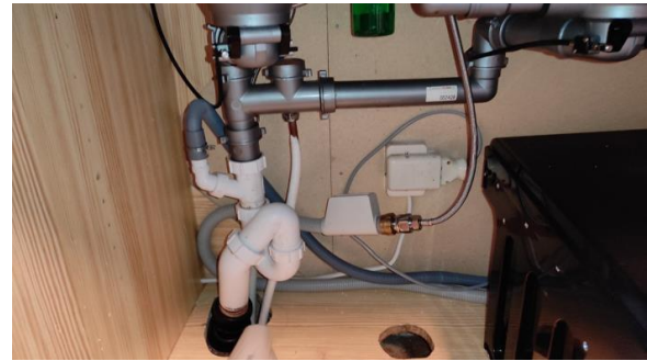
Kontroll etter lekkasjer.
