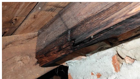
Råteskade ved pipen.
