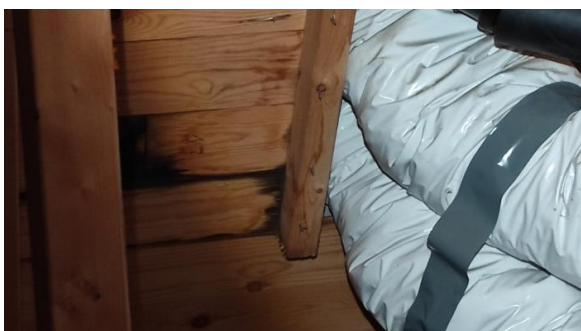
Fuktmerker rundt luftehatt på tilbygde del.
