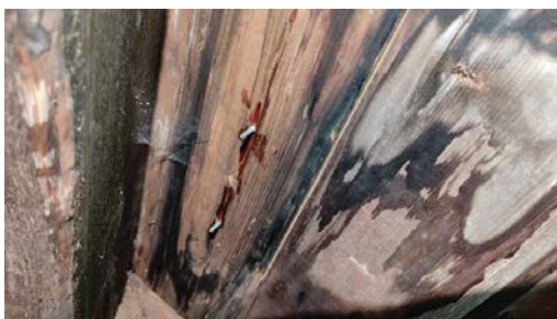
Lekkasje ved pipen.
