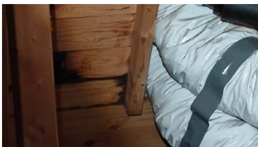
Fuktmerker rundt luftehatt på tilbygde del.
