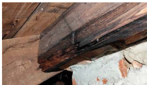
Råteskade ved pipen.
