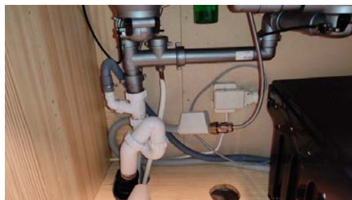
Kontroll etter lekkasjer.
