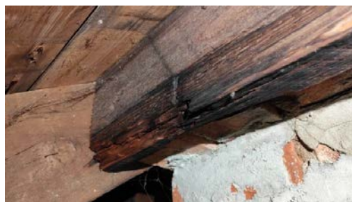
Råteskade ved pipen.
