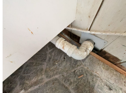
Del av rør til avløp.
