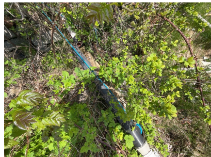
Her har rør "sklidd" fra hverandre .
