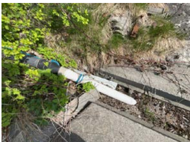
Rør før i mellom brygge og ut i sjøen .
