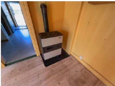
Montert ovn i stue.
