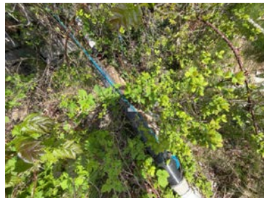
Her har rør "sklidd" fra hverandre .
