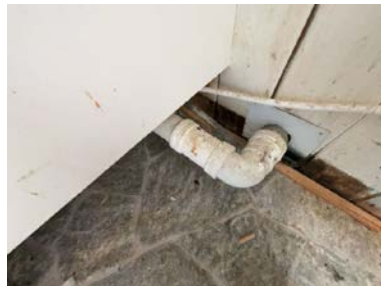
Del av rør til avløp.
