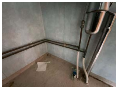
Del av rør til vann.
