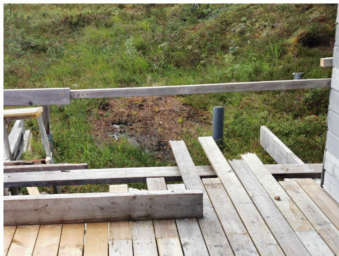
Mangel av rekkverk -ufagmessig
