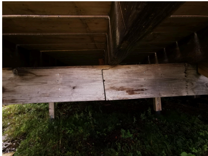
Brudd på tredrager under veranda Her ses materialer av uimpregnert virke på drager/trebjelkelag
