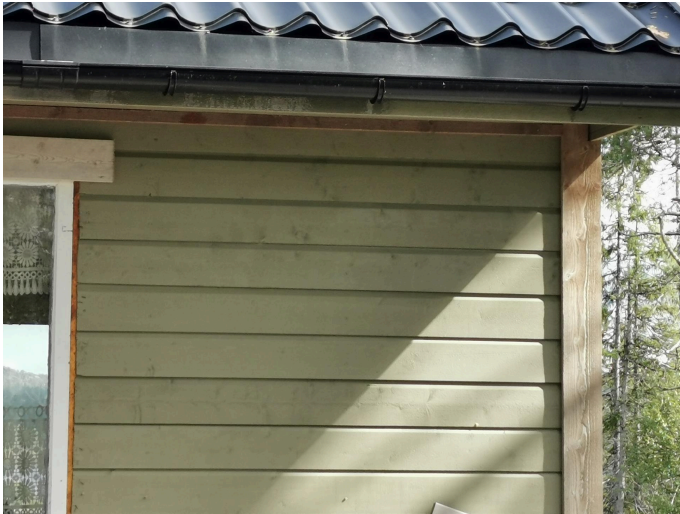
Mangler utstikk på takplater
