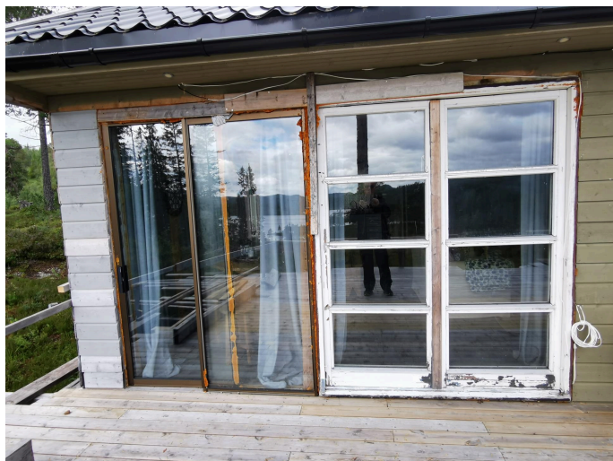
Eldre aludør og eldre vindu som mangler omramming
