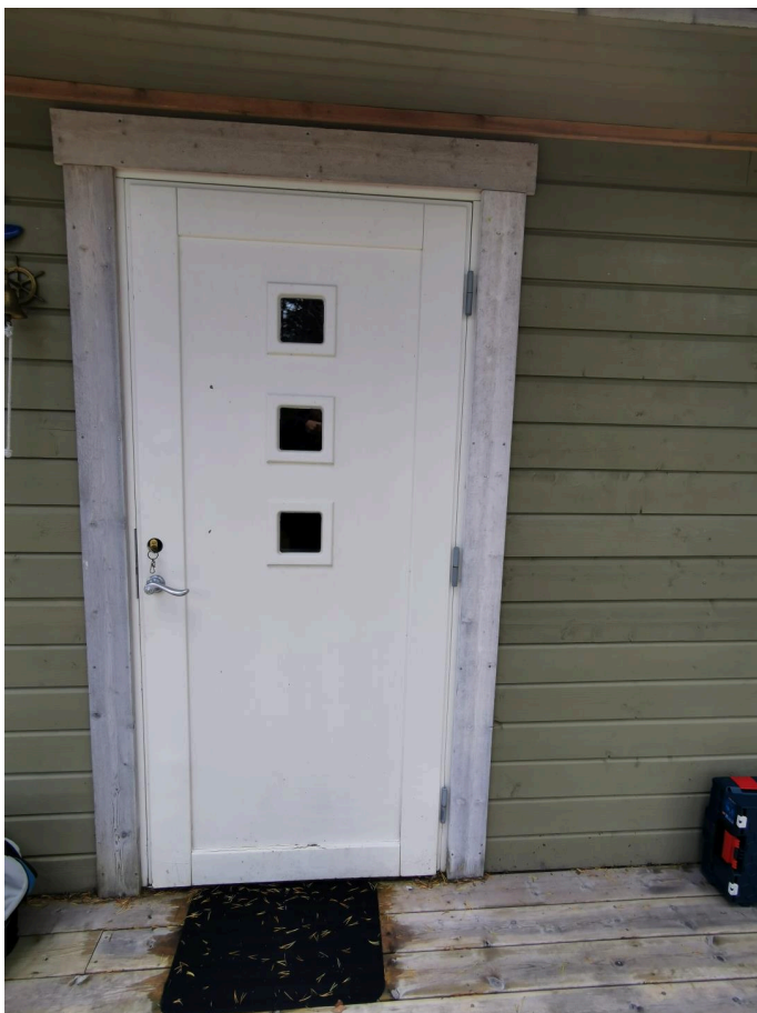
Ytterdør fuktskadet nedre del
