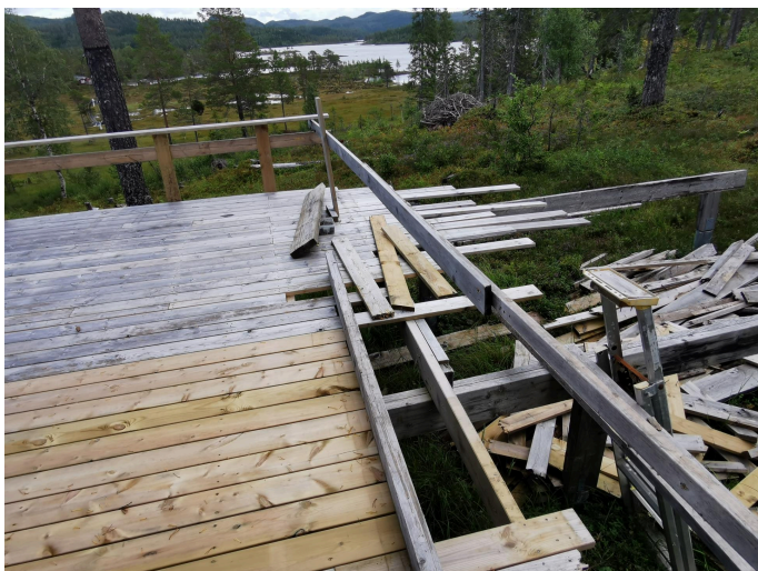
Mangel av rekkverk -ufagmessig
