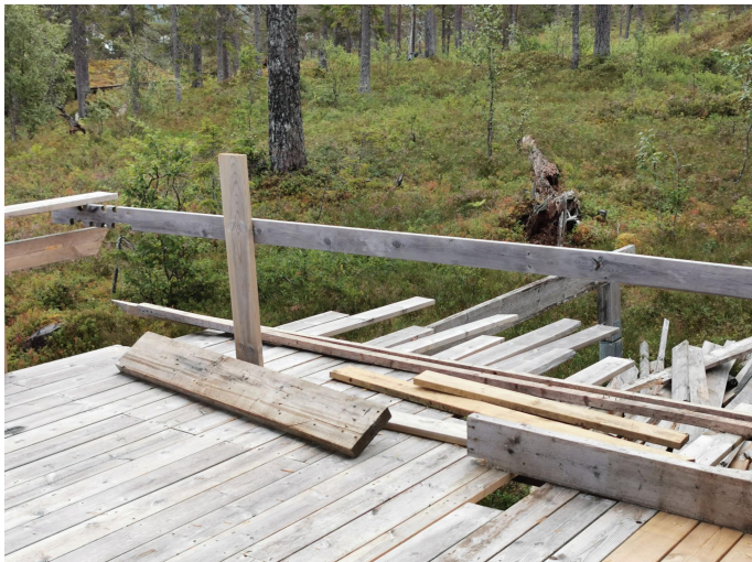
Mangel av rekkverk -ufagmessig
