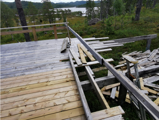
Mangel av rekkverk -ufagmessig
