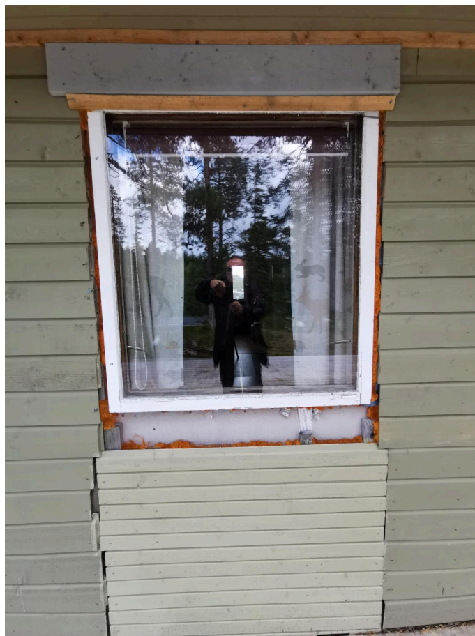
Eldre vinduer som mangler omramming
