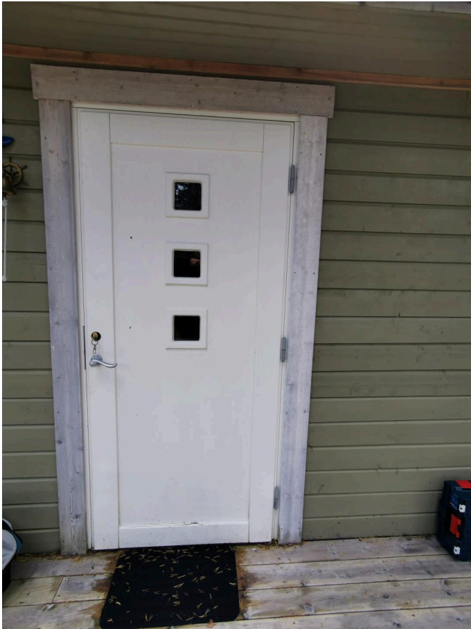
Ytterdør fuktskadet nedre del
