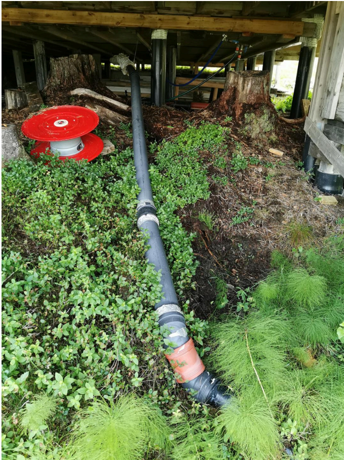
Åpen uisolert avløpsledning ligger på terreng
