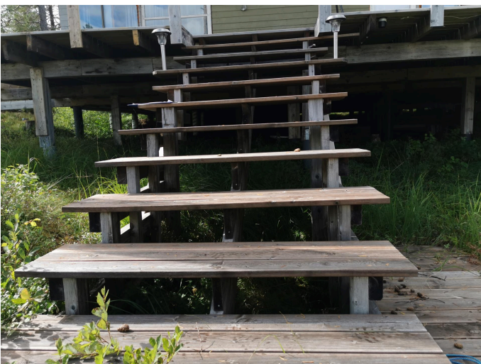
Trapp uten rekkverk
