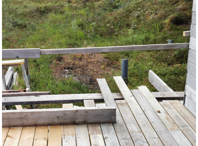
Mangel av rekkverk -ufagmessig
