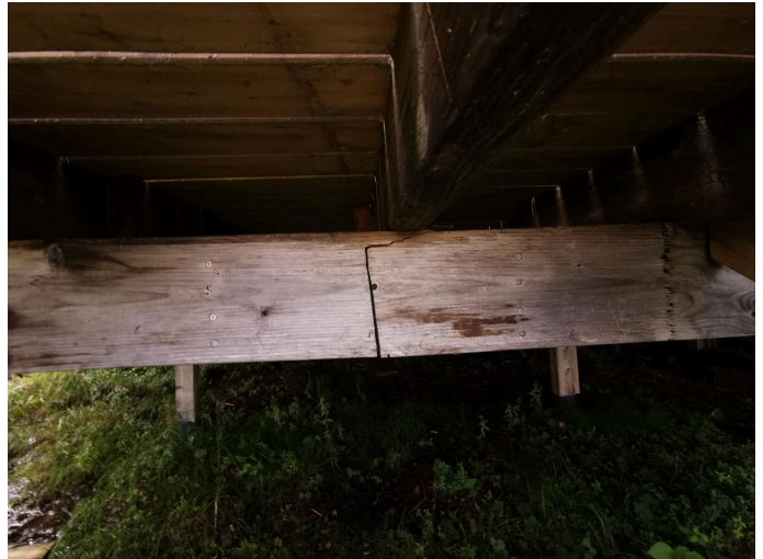
Brudd på tredrager under veranda Her ses materialer av uimpregnerert virke på drager/trebjelkelag
