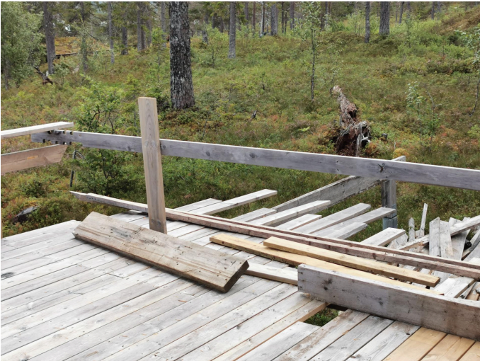
Mangel av rekkverk -ufagmessig
