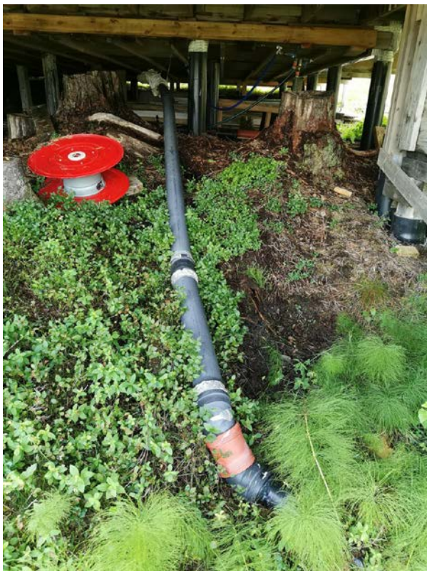
Åpen uisolert avløpsledning lig på terreng
