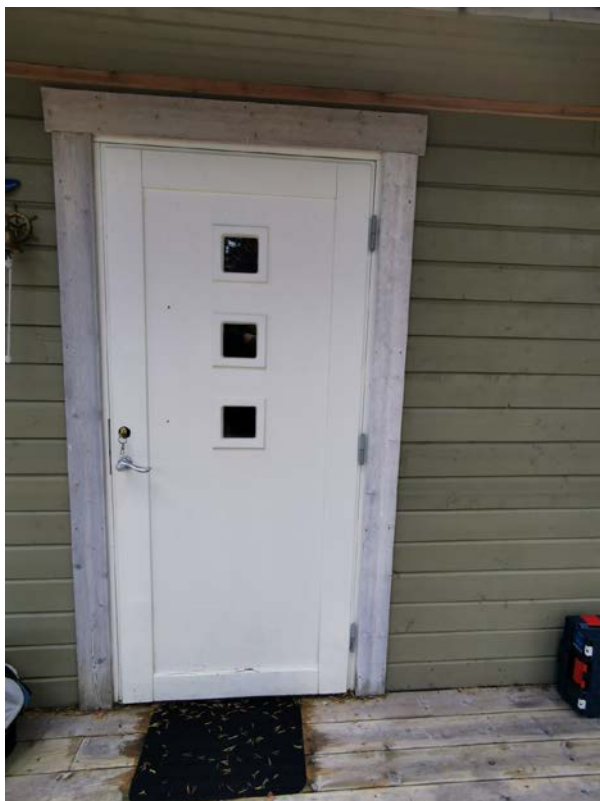
Ytterdør fuktskadet nedre del
