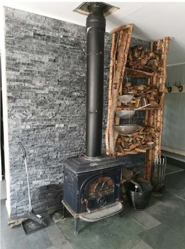
Bilde av eldre vedovn og isolert røykrør
