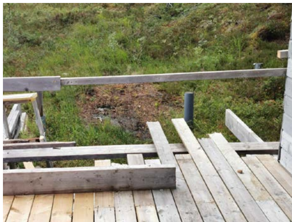
Mangel av rekkverk -ufagmessig
