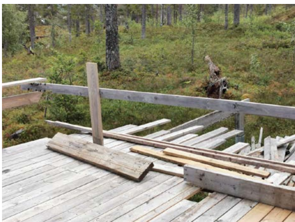
Mangel av rekkverk -ufagmessig
