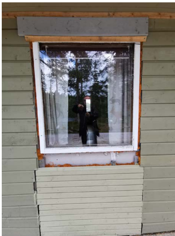
Eldre vinduer som mangler omramming
