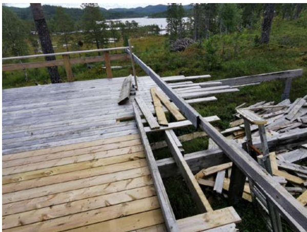
Mangel av rekkverk -ufagmessig
