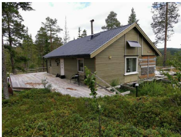
Manglende vindu på stue.
