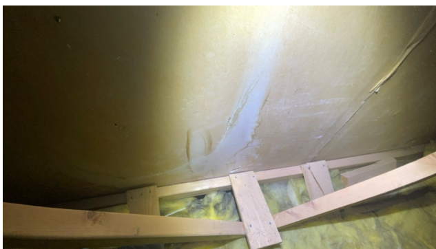
Skjolder på gipsplate ved leilighets-skille på loft (sansynlig lekkasje varm inneluft som har kondensert på kaldtloft)
