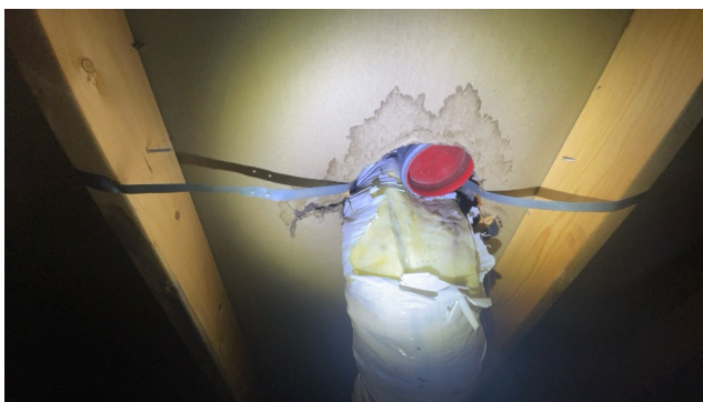
Skjolder ved luftehatt
