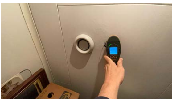
Liten svelling rundt ventil, men ikke avvik ved fuktsøk
