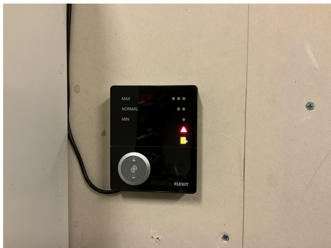
Rød varseltrekant på styrepanelet til ventilasjonsanlegget.
