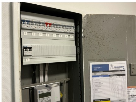
Automatsikringer i sikringsskap plassert i gang/fellesareal.
