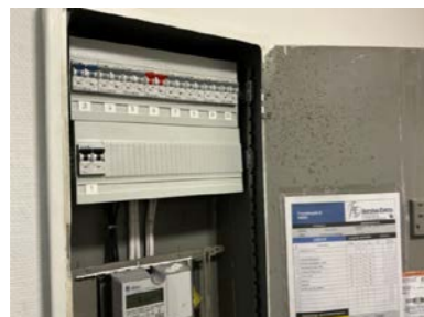
Automatsikringer i sikringsskap plassert i gang/fellesareal.
