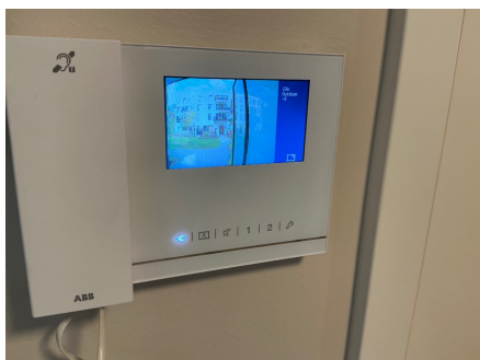
Dørcalling med monitor er plassert i entré.
