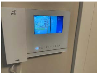
Døralling med monitor er plassert i entré.
