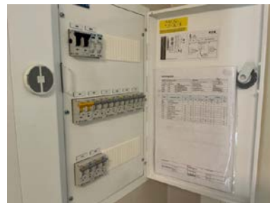
Automatsikringer i sikringsskap plassert i entré.
