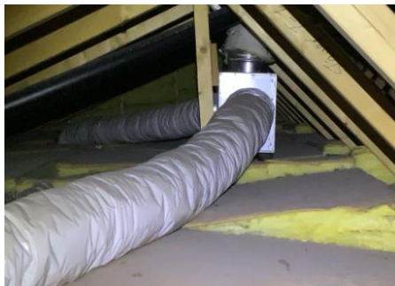
Avtrekksvifte er plassert på loft.
