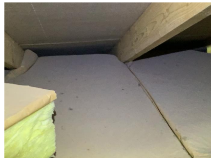
Det er lufting fra raft.
