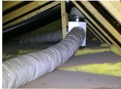
Avtrekksvifte er plassert på loft.
