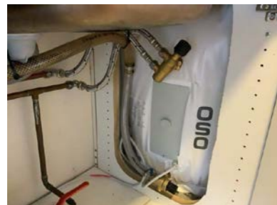
Vanndeteksjon anbefales montert under kjøkkenbenk.
