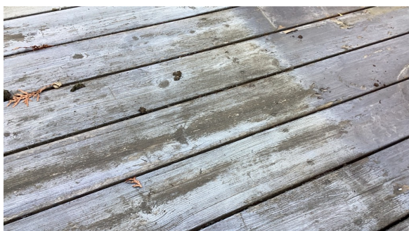
Eksempel på slitasje.
