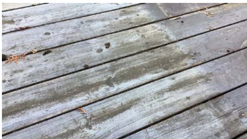
Eksempel på slitasje.
