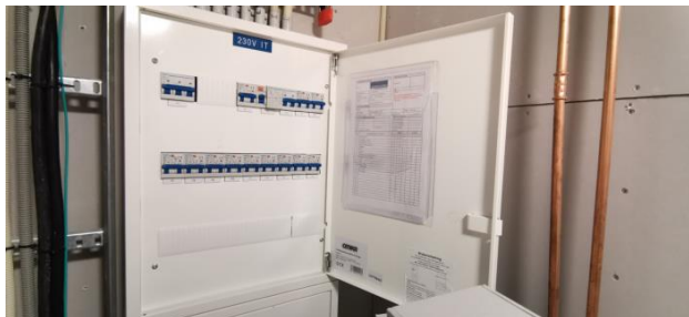
Kontroll av el-skapet.
