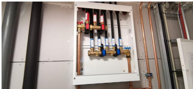
Kontroll av fordelskapet.
