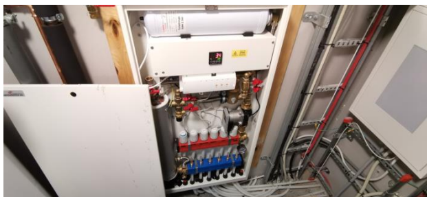
Fordelerskap plassert i felles teknisk rom.
