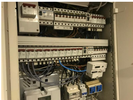
Manglende deksler i skap.
