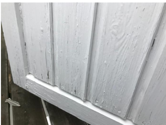
Stor værslitasje utvendig på terrassedører.
