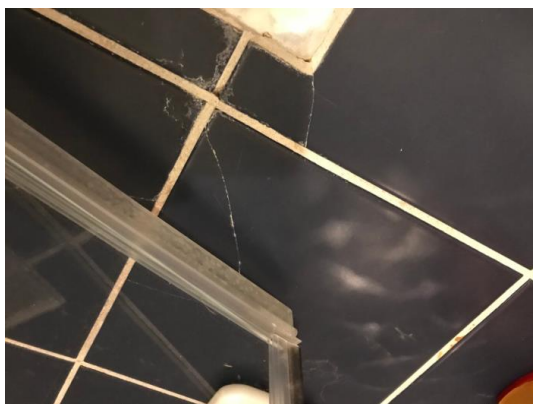
Sprekker i fliser.
