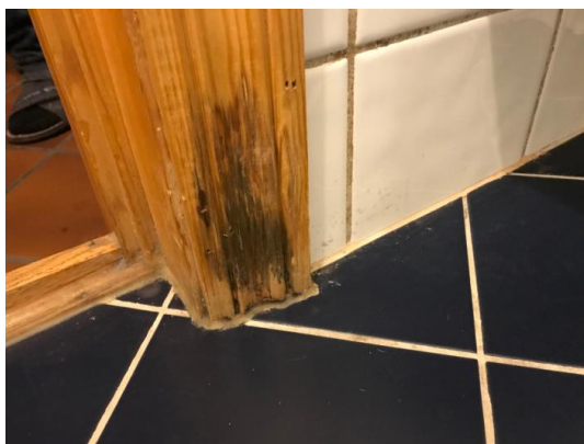
Fuktskade på dørlist.
