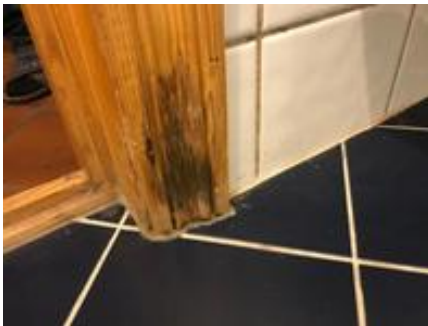
Fuktskade på dørlist.
