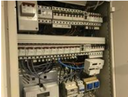
Manglende deksler i skap.
