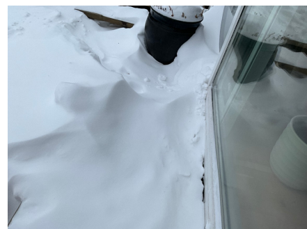
Bør holdes fritt ved snø, foringer levetiden betraktelig.
