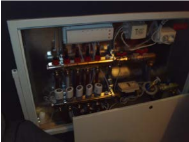
Fordelerskapet for gulvvarme og varmtvann.
