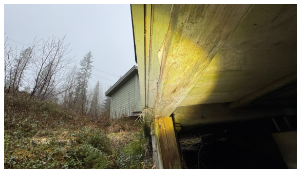
Det er ingen lufting bak bordkledningen.
