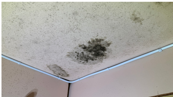
Soppvekst i himling i utvendig bod.
