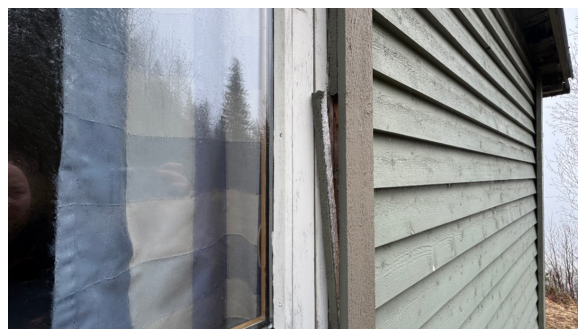
Omremming rundt vindu har skade.
