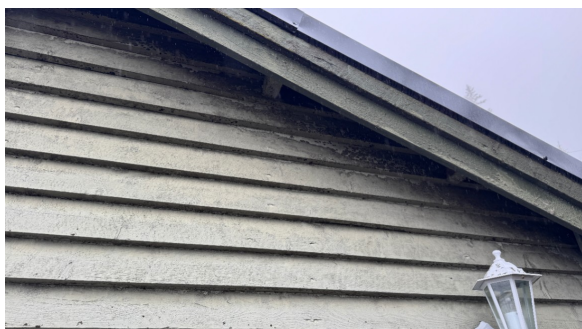
Det er registrert noe soppvekst på bordkledningen.
