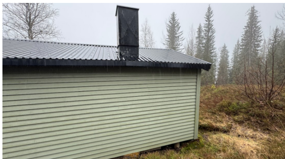
Takrenne mangler på fasade mot nord. Det er ikke montert snøfangere.
