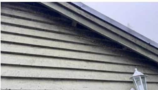
Det er registrert noe soppvekst på bordkledningen.
