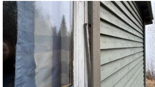
Omremming rundt vindu har skade.
