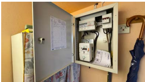
Kontroll av el-skap og kursfortegnelse.
