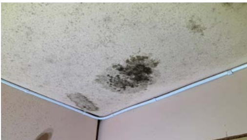
Soppvekst i himling i utvendig bod.
