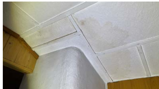
Det er registrert noe fuktmerker i himlingen rundt pipen.
