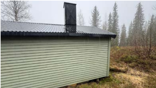
Takrenne mangler på fasade mot nord. Det er ikke montert snøfangere.
