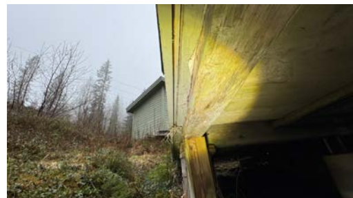
Det er ingen lufting bak bordkledningen.
