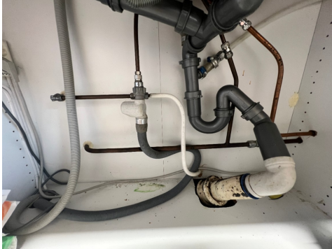
Røropplegg under kjøkkenbenk
