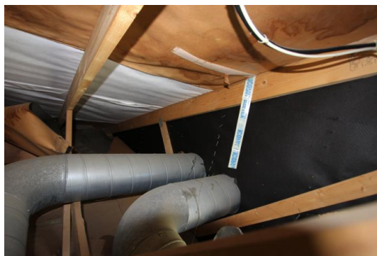
Ventilasjonsaggregat montert på loft.
