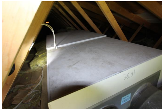
Ventilasjonsaggregat montert på loft.
