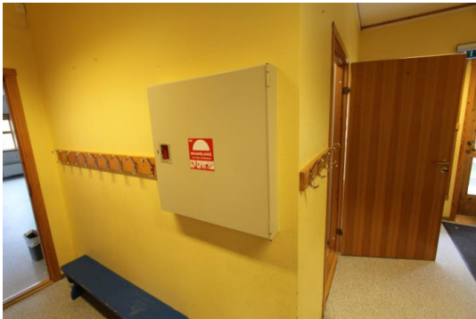
Brannslange montert i gang.
