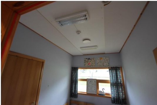
Brannvarsling montert i tak
