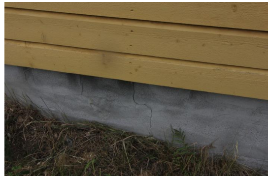
Leca grunnmur med puss med registrert sprekker.
