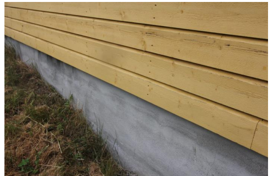
Leca grunnmur med puss med registrert sprekker.
