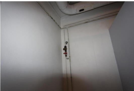
Røropplegg i kjeller av kobber rør.
