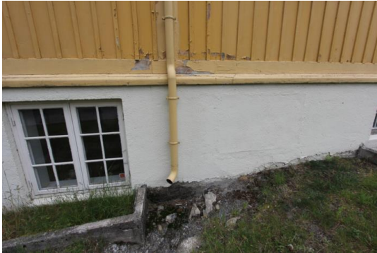
Taknedløp avsluttet over bakke.
