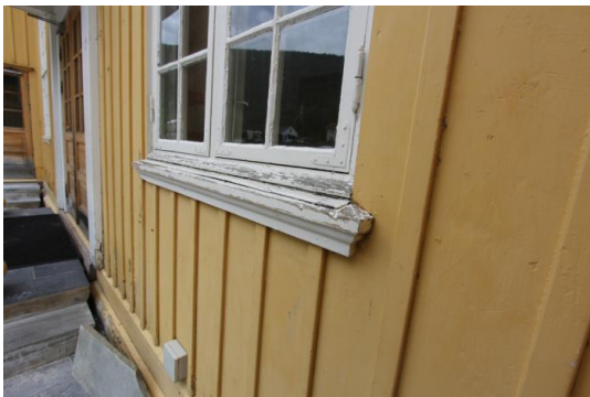
Værslitt behandling av vindusrammer.
