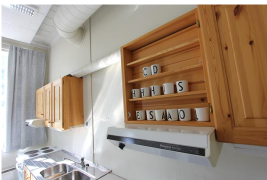
Montert ventilator med avtrekk.
