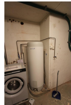
Nyer montert vvs tank vaskerom kjeller.
