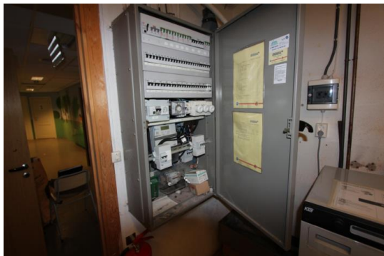
El. tavle stående i vaskerom kjeller.
