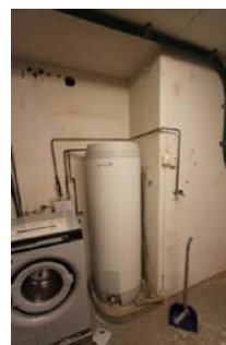
Nyer montert vvs tank vaskerom kjeller.
