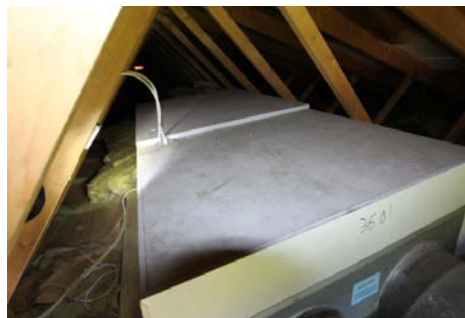
Ventilasjonsaggregat montert på loft.
