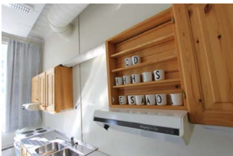
Montert ventilator med avtrekk.
