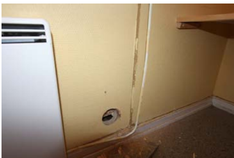
Hulltaking i vegg klasserom kjeller.
