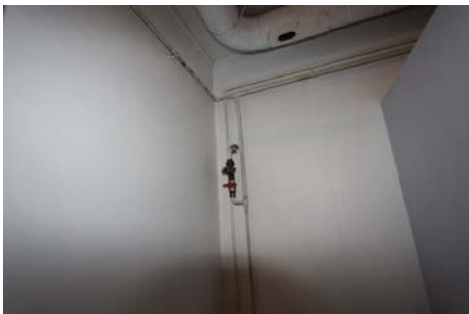
Røropplegg i kjeller av kobber rør.
