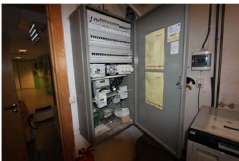
El. tavle stående i vaskerom kjeller.
