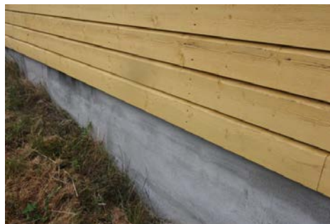
Leca grunnmur med puss med registrert sprekker.
