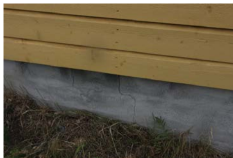
Leca grunnmur med puss med registrert sprekker.
