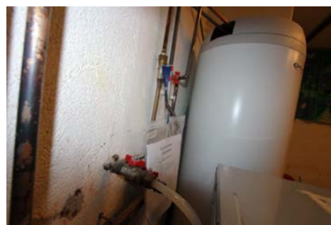
Nyer montert vvs tank vaskerom kjeller.
