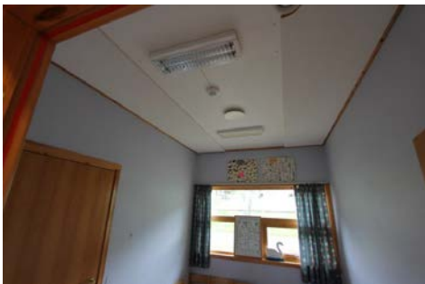
Brannvarsling montert i tak
