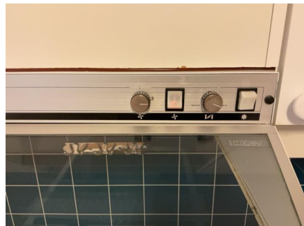
Avtrekk på bad styres fra kjøkkenventilator.
