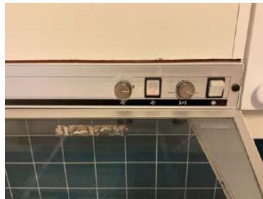
Avtrekk på bad styres fra kjøkkenventilator.
