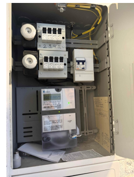
Bildet viser sikringskapet plassert i felles trapperom.
