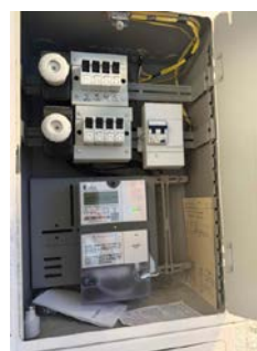
Bildet viser sikringskapet plassert i felles trapperom.
