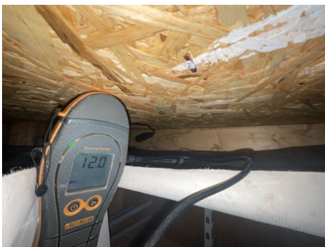
Marginale skjolder og lav fuktmåling over vindsperre
