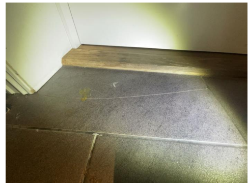
Sprekk i flis entre.
