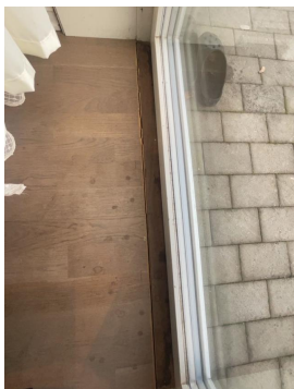
Oppsprekk fuge ved stuevindu/dør 1.etg.
