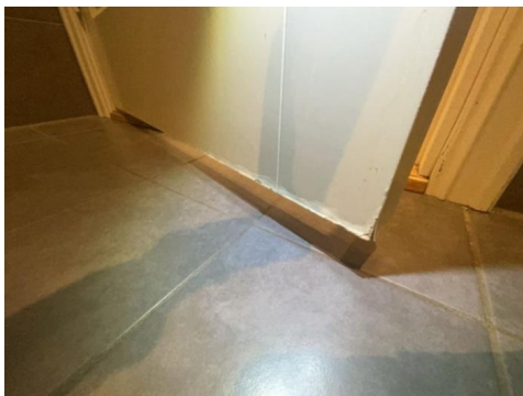
Svelling nedkant dørrblad bad 1.etg.
