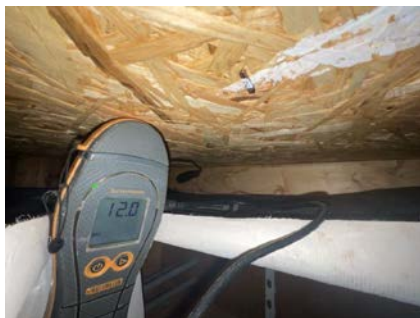
Marginale skjolder og lav fuktmåling over vindspærre
