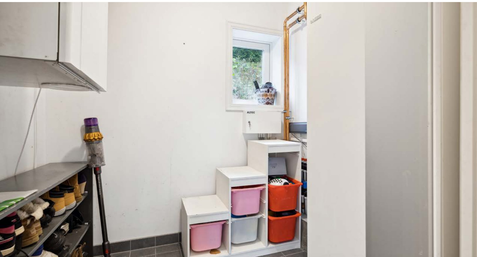
Teknisk rom/bod som inneholder varmepumper, sentralstøvsuger og ventilasjonsagregat.
