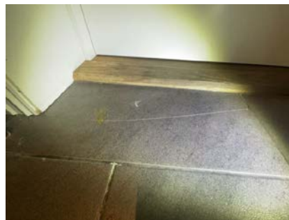
Sprekk i flis entre.
