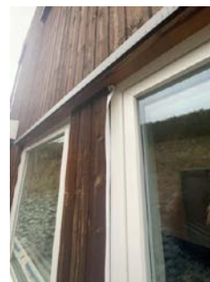
Manglende foring/glippe hvor not er avsluttet mot vindu
