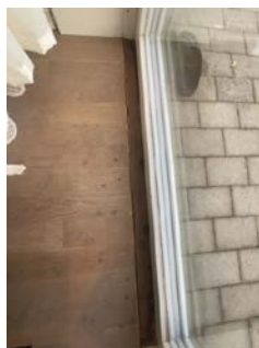
Oppsprekk fuge ved stuevindu/dør 1.etg.
